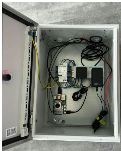
Figure 17 - Intérieur de notre coffret électrique
